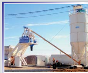
Бетонный завод МЕКА на расширении Каспийского трубопроводного консорциума
