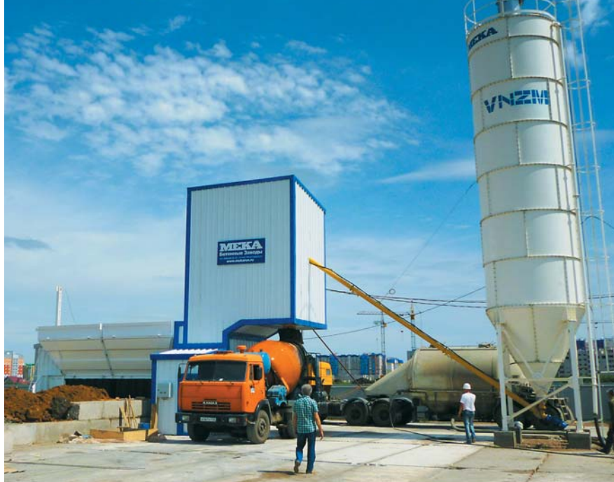
г. Sterlitaamak, Бетонный завод MEKAMIX-20
